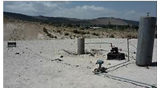
Figura 1. Sistema de captación de biogás
