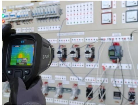
Figura 3. Tablero de Control [Autor]
