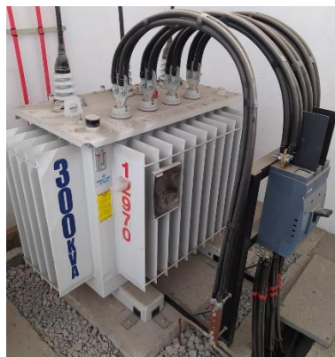
Figura 2. Cámara de transformación UTC [Autor]
